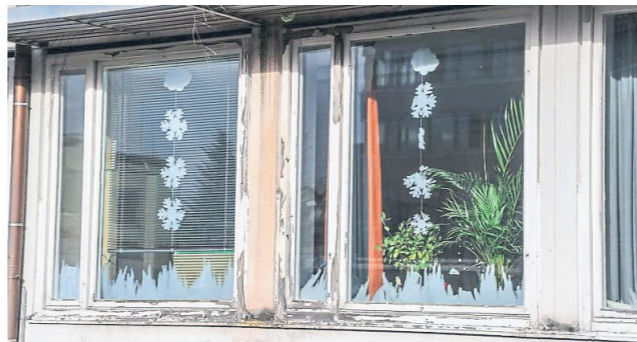
Desolater Zustand: So sieht die Fensterfront der Markt Schwabener Schule aus. FOTO: DZIEMBALLA
